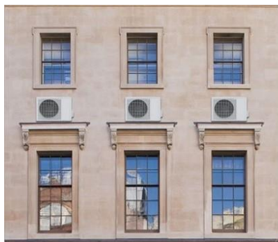
Neprihvatljivo postavljanje postavljanje
